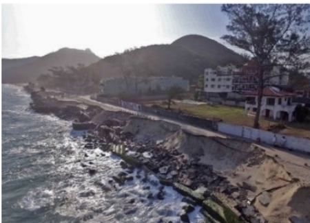
Fig. 3 – Colapso de estrutura no Rio de Janeiro, Brasil (Bulhões, 2020).
