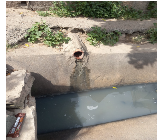
Figura 2- Ponto de descarga sem tratamento (entrada contínua de águas residuais domésticas na vala)
