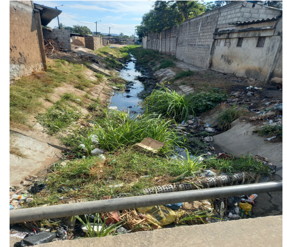
Figura 1- Vala com presença de resíduos sólidos.
