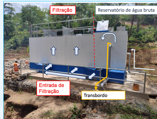
Tanque de filtração (45m 3 )
