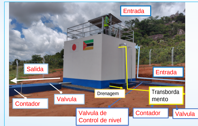
Depósito apoiado Este(50m 3 )
