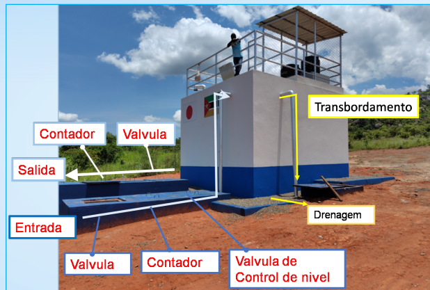
Depósito apoiado Oeste(50m 3 )
