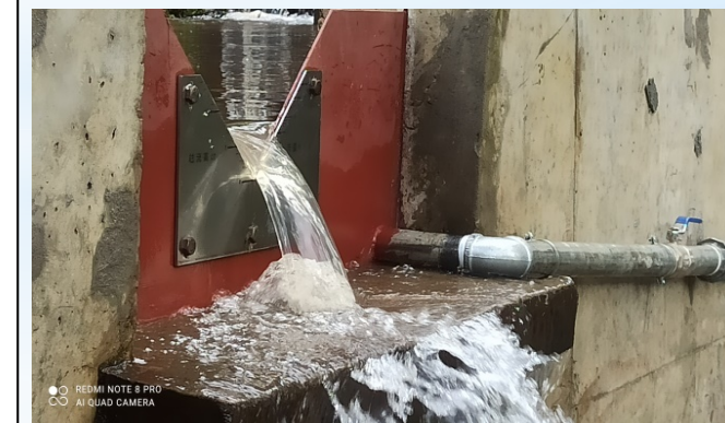
Vertedor triangular instalado neste ano
