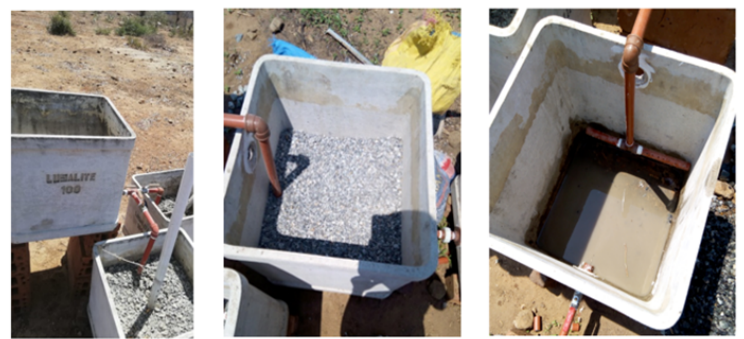
(a)Válvula de alimentação dos leitos (b)Camada inferior de gravilha (c) Tubagem em T
